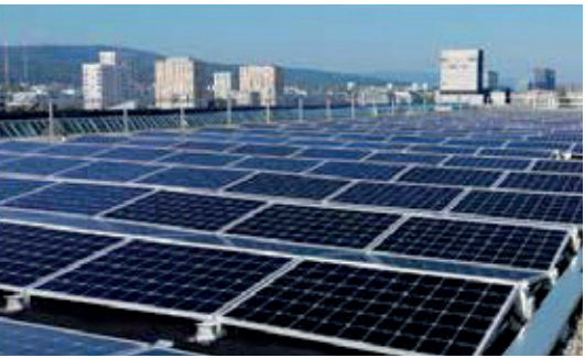
PV-Anlage Kellenberger (ca. 2500 m 2 )
