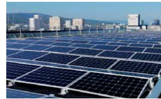
Installation PV de Kellenberger (env. 2500 m 2 )
